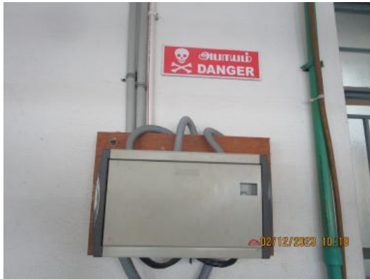
Electrical switch box.JPG
