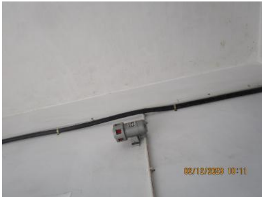
Fire alarm siren.JPG
